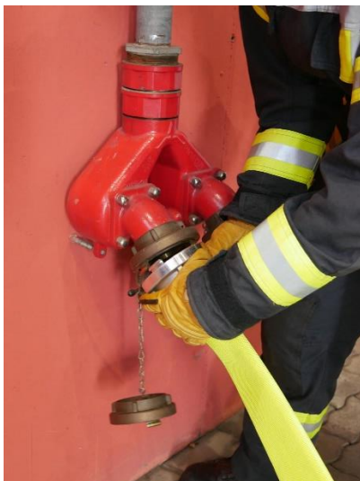
4.3-3 Eine Einsatzkraft kuppelt einen Schlauch an die Festkupplung einer Löschwassereinspeisung
