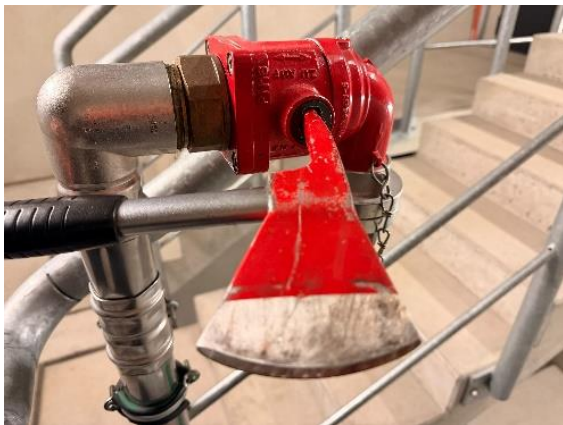
6.5.4-2 Bedienung des Absperrorgans eines Löschwasseranschlusses beispielhaft mit Feuerwehrbeil
