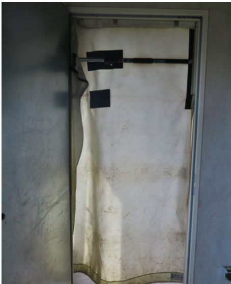
Abb. 23: Gesetzter mobiler Rauchverschluss
