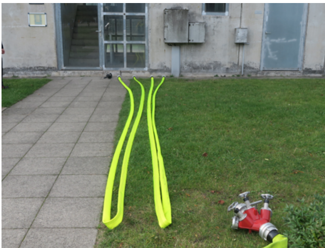
Abb. 7: Beispielhaft liegen 2 Rollschläuche ausgerollt neben dem Zugang zum Gebäude.
